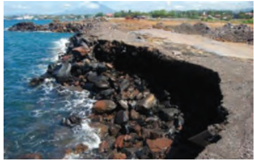
Sumber: informasipangandaran.com Gambar 3.42 Abrasi di pantai yang tidak ditumbuhi hutan mangrove
